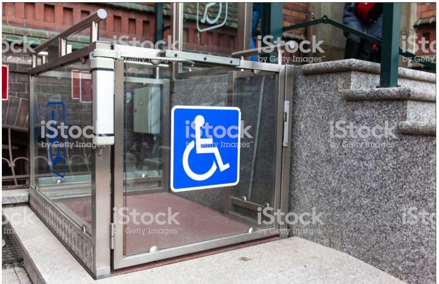
Aufzug neben der Treppe am Eingang
